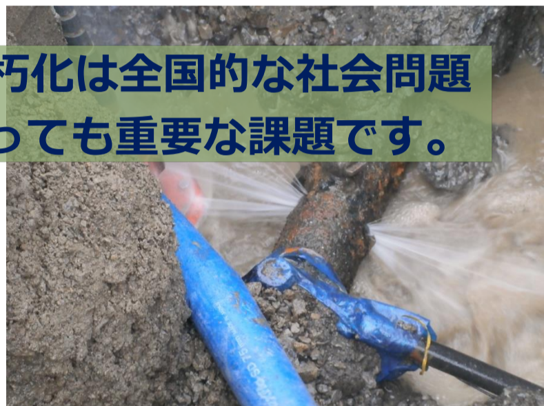
▲老朽化した水道管から漏水
