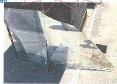
割れた鏡・割れたガラス
