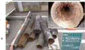
老朽化した水道管
