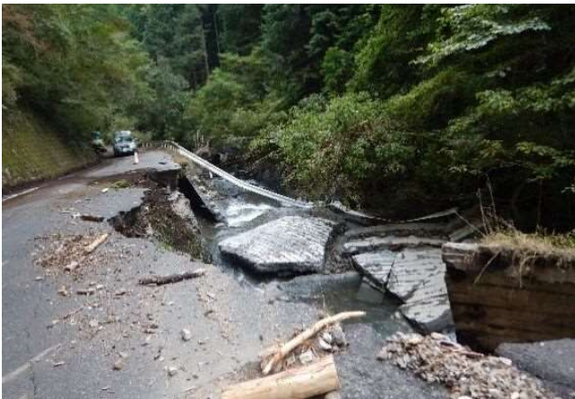
【写真③】 農道具伏宝ノ窪線 （清水区河内）の被災状況
