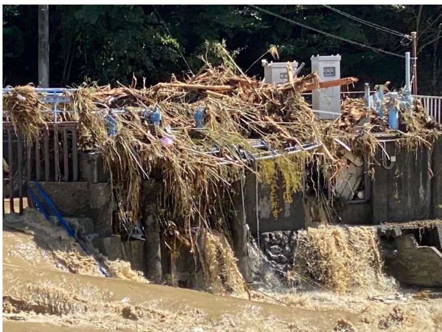
承元寺取水口(清水区承元寺町)の被災状況
