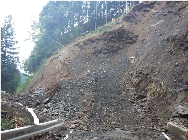
【写真①】 （主）南アルプス公園線 （葵区大間）の被災状況
