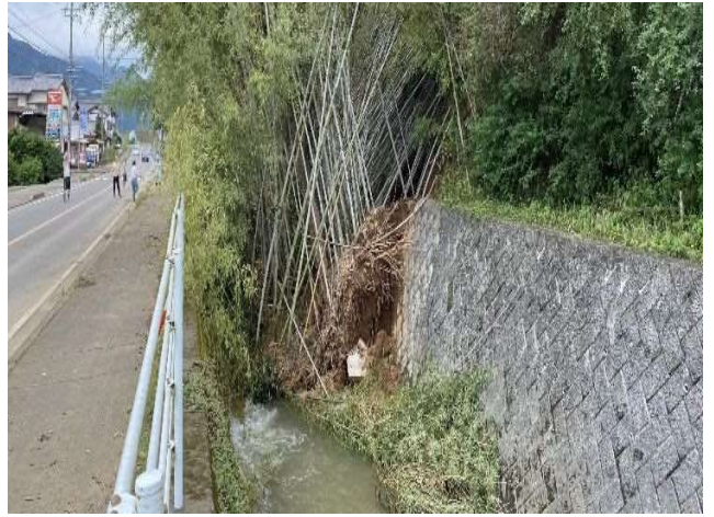
【写真②】 （準）門屋川 （葵区門屋）の被災状況
