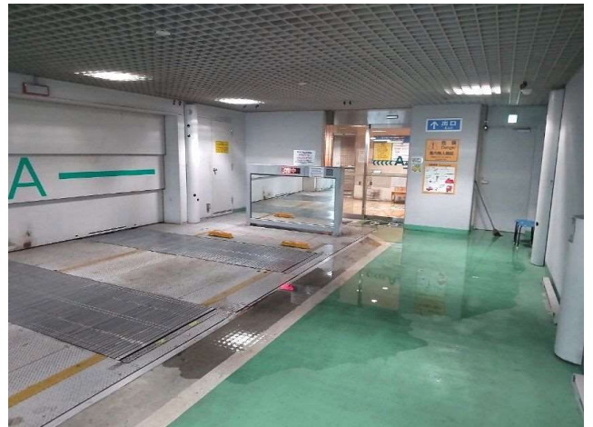
【写真⑩】 静岡駅北口地下駐車場 (葵区黒金町)の被災状況
