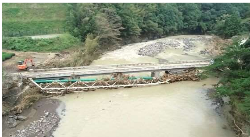
【写真⑪】 和田島地区宮嶋橋(水管橋) (清水区和田島)の被災状況
