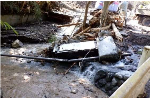
【写真⑨】 松野学区農業集落排水施設 (葵区油山)の被災状況
