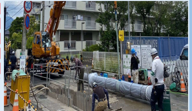
管の耐震化・老朽化対策
