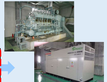
清水谷浄水場 非常用自家発電設備の更新 上：更新前 下：更新後
