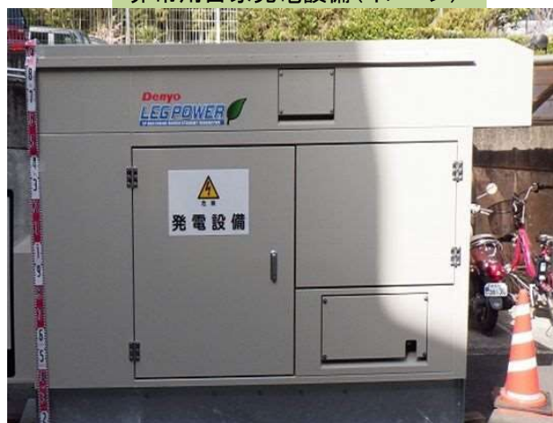
非常用自家発電設備(イメージ)
