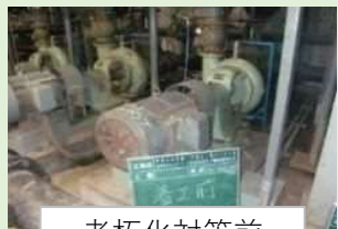
老朽化対策前
