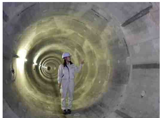
広野2号雨水幹線(φ2,600mm) (平成29年度に一部区間完成)
