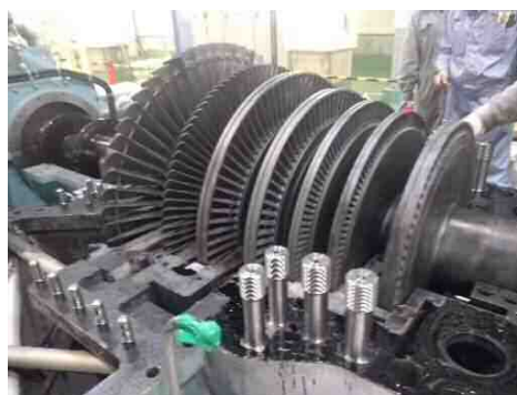
蒸気タービン発電機
