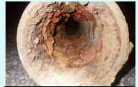
老朽化した水道管
