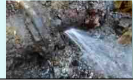
老朽化した水道管から漏水
