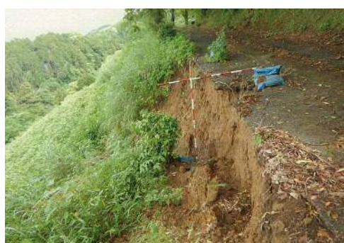
農道茅ヶ間2号線の被災状況
