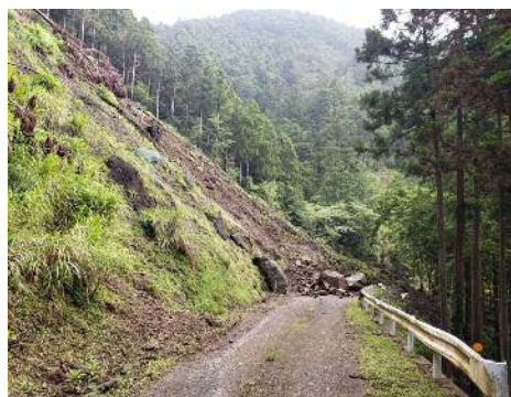
林道樫ノ木峠線の被災状況
