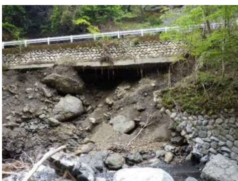
(市) 仙俣線の被災状況
