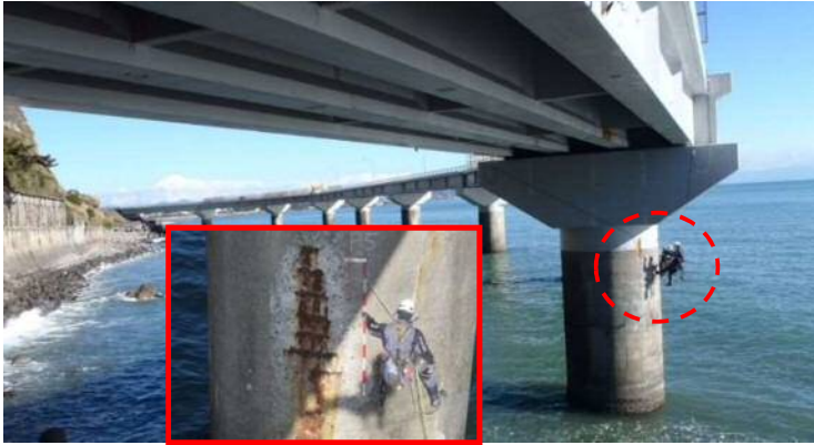
石部海上橋の老朽化の様子
