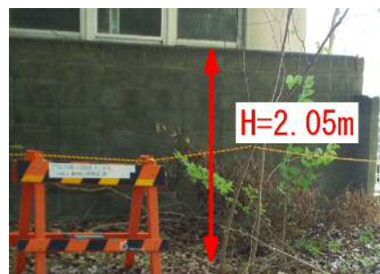
不適合ブロック塀の例 (高さが2.0mを超過)
