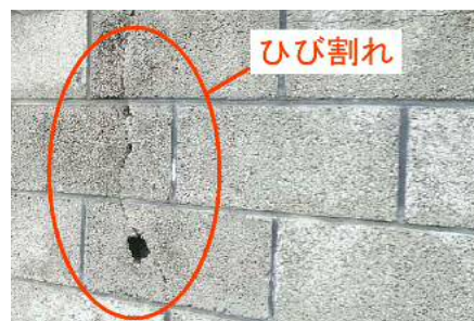
危険なブロック塀の例 (ひび割れあり)
