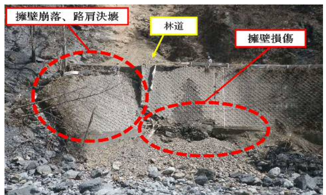
崩落した林道東俣線
