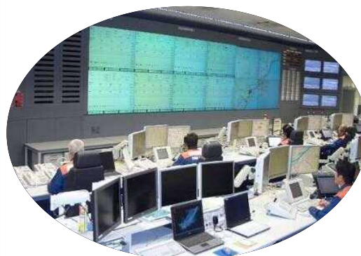
消防総合情報システム
