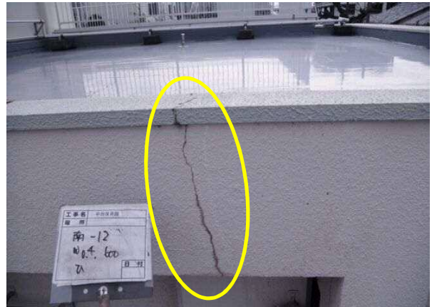
ひび割れの例
