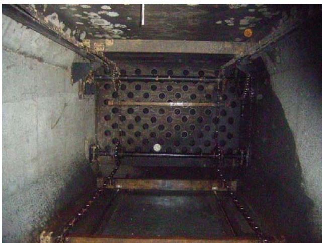
老朽化した汚泥掻寄機
