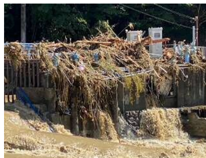
承元寺取水口への流木等流入
