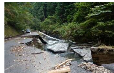
農道具伏宝ノ窪線の崩土被害
