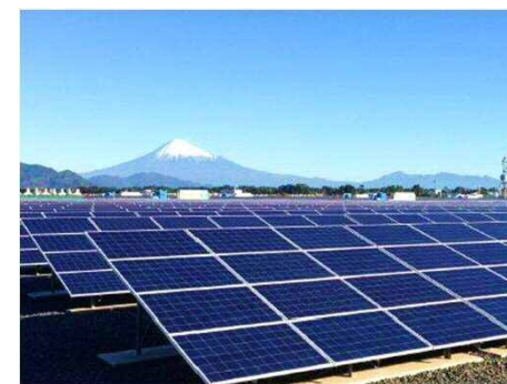
市内に整備された太陽光発電設備（整備のイメージ）
