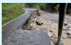
台風被害による路肩崩壊
