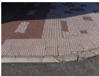
歩道に段差がある
