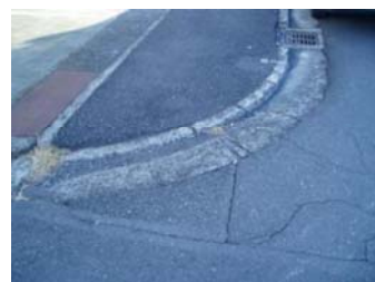
歩車道境界の段差がある 誘導ブロックの未設置
