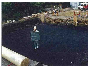
(空隙貯留浸透施設：プラスチック製品)
