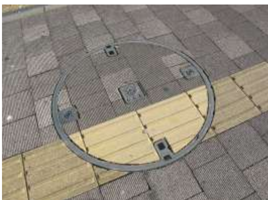
視覚障害者誘導用ブロックをマンホールの蓋にも敷設することで、途切れのない誘導を可能にしています(静岡市)
