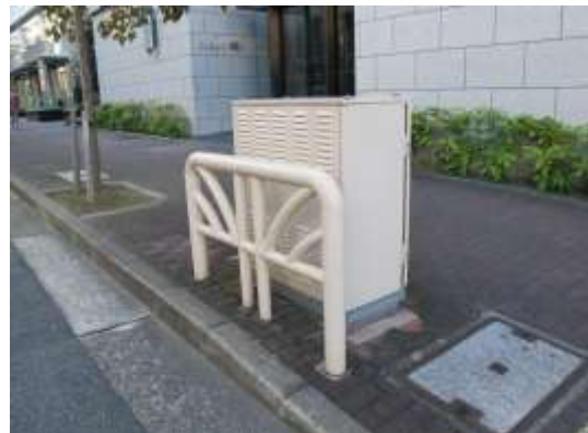
防護柵も電線共同溝地上機器と同じ色に塗装されることで、統一感が生まれています(名古屋市)
