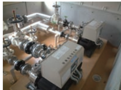
点検作業が容易で給水系統が明確である。
