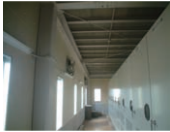
換気装置などにより設備機械室の環境保全に努める。
