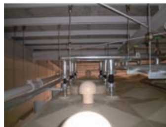
給水系統のフレキシブル継手
