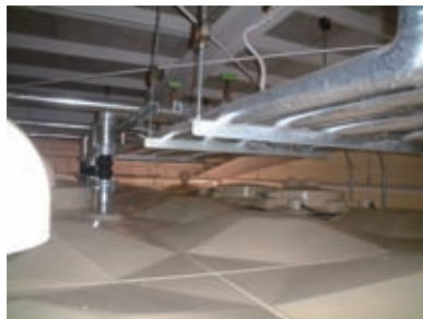
作業空間の確保が望まれる。
