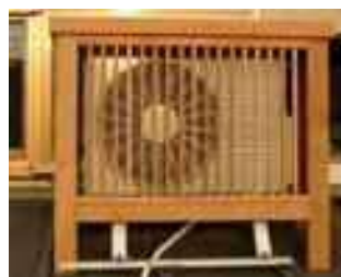
エアコン室外機カバー
