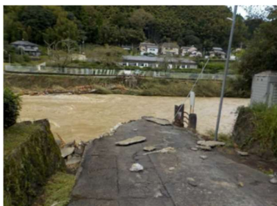
清池1号線(橋梁全壊)
