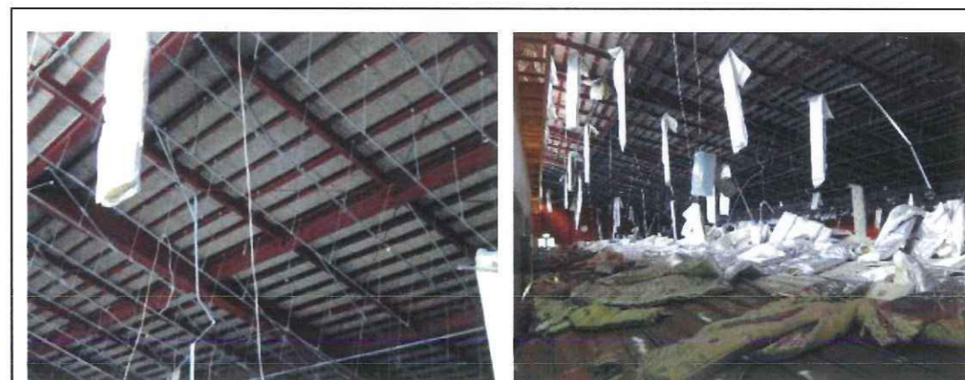
H26熊本地震により天井が脱落した室内の状況
