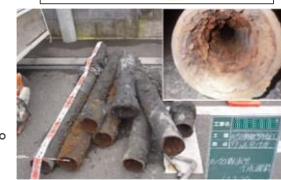
老朽化した水道管
