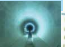
▲下川原雨水貯留管
