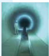
▲下川原雨水貯留管
