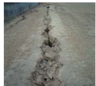
岩手県立高田高校第2グラウンドの亀裂
