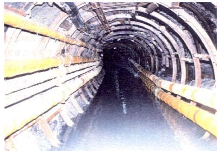
写真 配管状況
