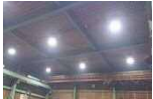
LED照明 改修後
