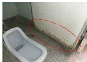
写真2: ドアの損傷・腐食
