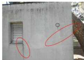
写真5: 壁面のひび割れ
