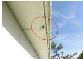
写真6：軒裏（鉄筋露出）
