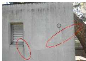
写真5: 壁面のひび割れ
