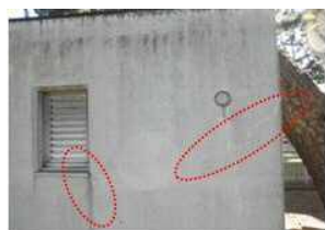
写真5：壁面のひび割れ
