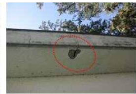
写真4：軒裏（鉄筋露出）
