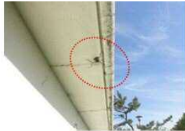
写真6：軒裏（鉄筋露出）
