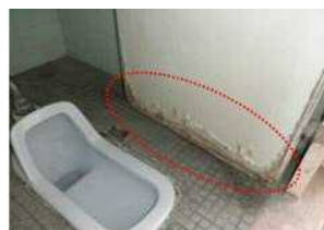
写真2：ドアの損傷・腐食
