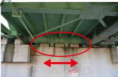
落橋防止システム
