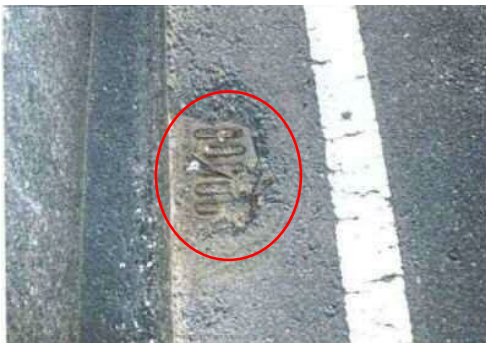
排水柵に土砂詰りが生じた例
