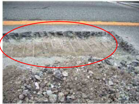
床版上面の土砂化の例
