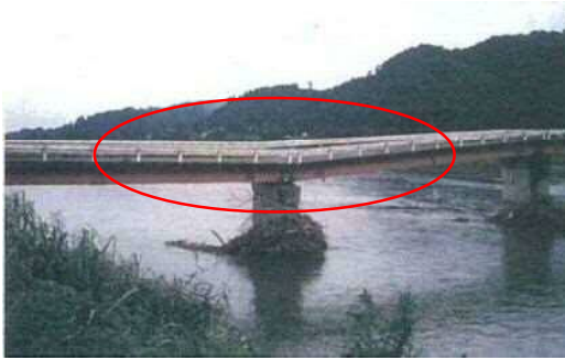
橋脚の沈下による通りの異常例
