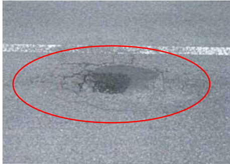
舗装のポットホールの例
