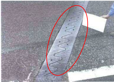
遊間が異常に狭く伸縮装置の櫛の歯が完全に閉じている例
