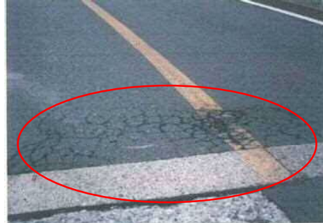
舗装のひびわれ幅が 5mm 以上ある例
