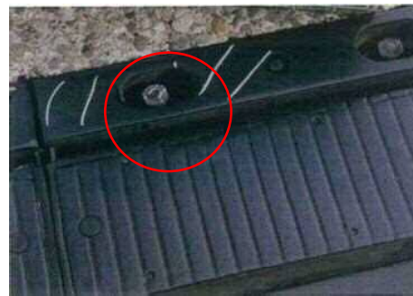
伸縮装置のボルトの緩みにより、異常な音が発生した例
