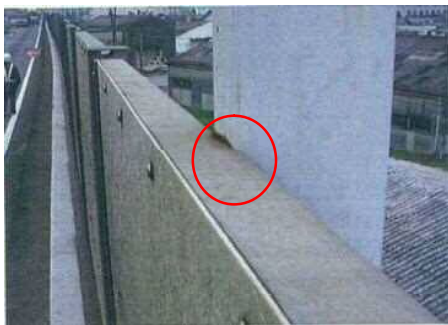
遮音壁と照明柱が干渉して、異常な音が生じた例
