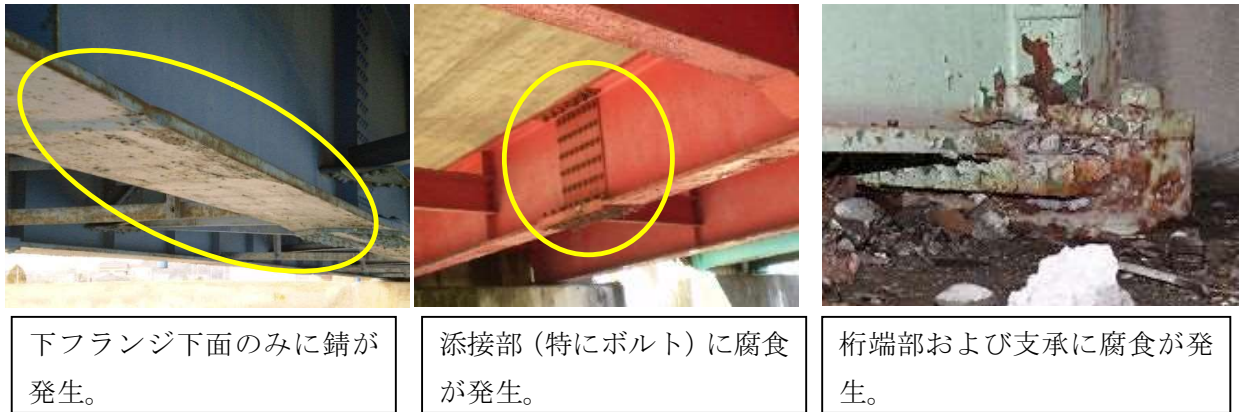
写真-5.2.1 局所的な塗膜劣化の発生例
