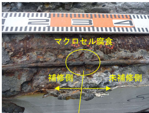
図-5.5.1 マクロセル腐食事例
