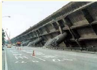
倒壊した高架橋(1995年 阪神・淡路大震災)
