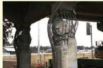
破断寸前の橋脚(2011年 東日本大震災)
