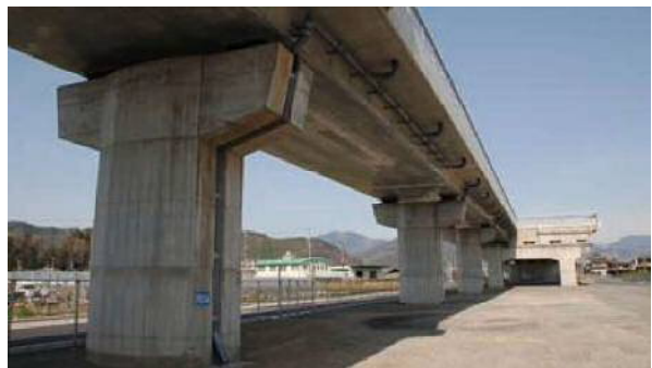
現在の耐震基準を満たしている橋脚 (阪神・淡路大震災以降(平成8年以降)の基準)
