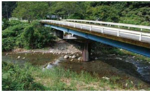
現在の耐震基準を満たしていない橋脚 (昭和55年より古い基準)
