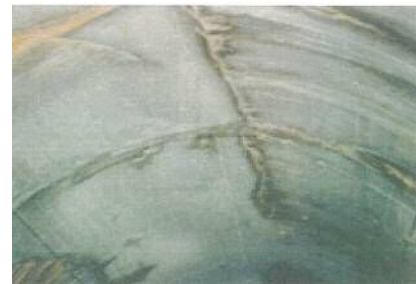
覆工天端付近のひび割れ
