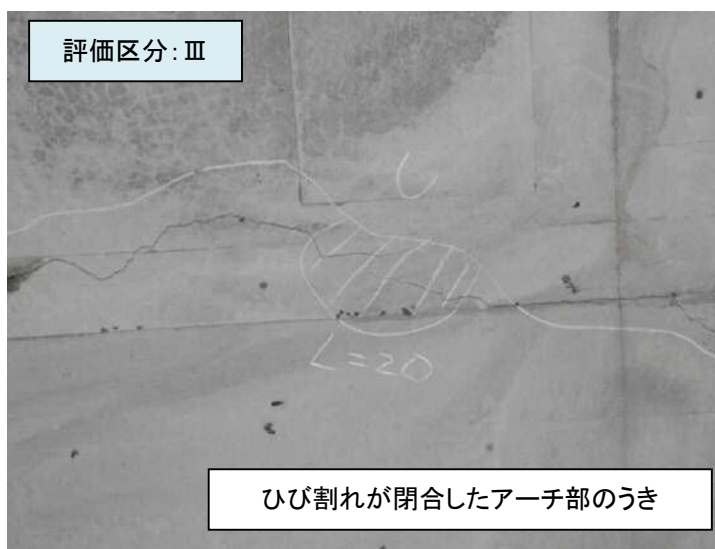
図- 10.7 損傷例(覆工:うき・はく離・はく落):大原丸秀トンネル SP13
