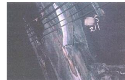
補修モルタルのはく離
