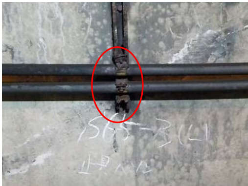
写真-10.3 取付金具の腐食(Ⅲ判定)
