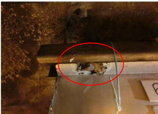
写真-10.1 腐食による本体の断面欠損(Ⅲ判定)
