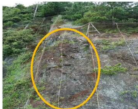
写真-10.9 落石防護柵の断面欠損の例
