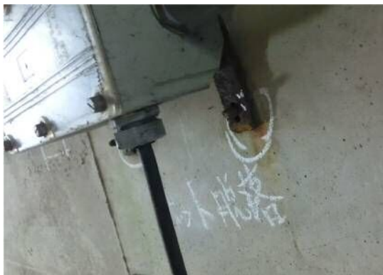
写真-10.5 ナットの脱落(Ⅲ判定)
