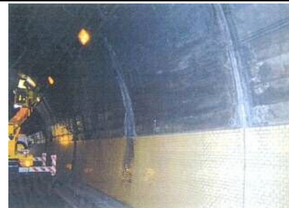
スパン中間付近のひび割れ
