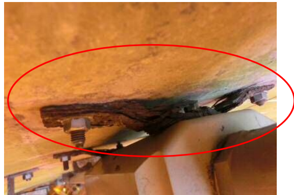
写真-10.4 取付金具腐食によるボックス落下の可能性
