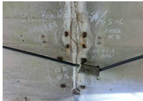
写真-10.6 取付金具の脱落(Ⅲ判定)
