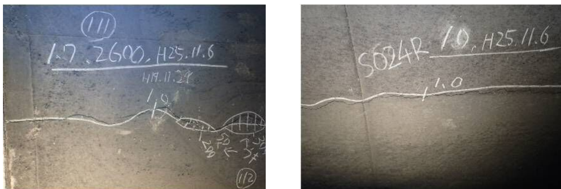
写真-5.1 ひび割れのマーキング例
