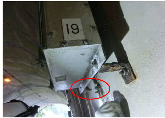
写真-10.2 腐食による本体の欠損(Ⅲ判定)
