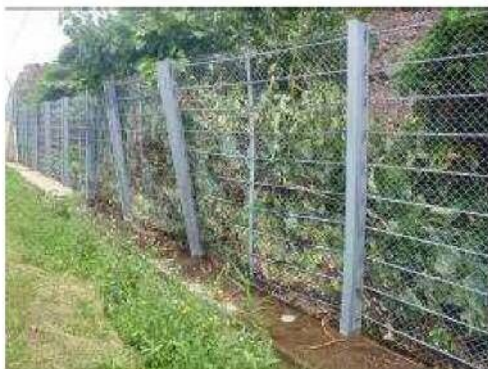
写真-10.8 落石防護柵の傾動の例
