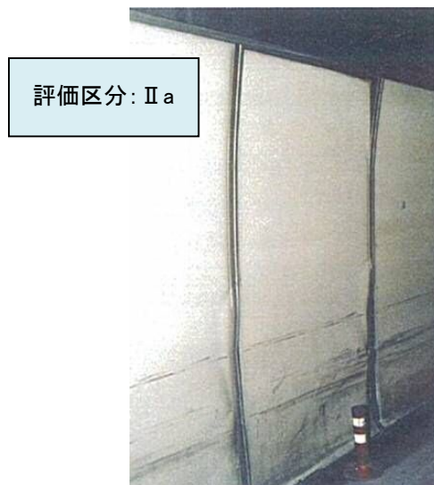
図-10.25 損傷例(内装板の変形)
