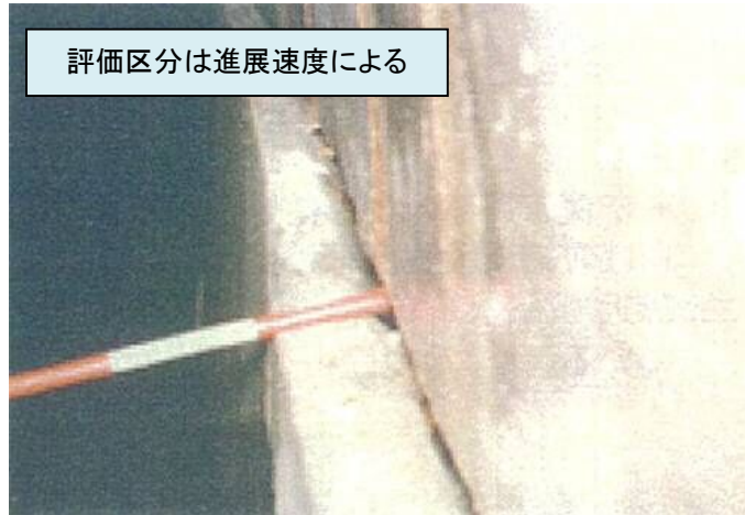
図-10.16 損傷例(覆工:傾き・変形)
