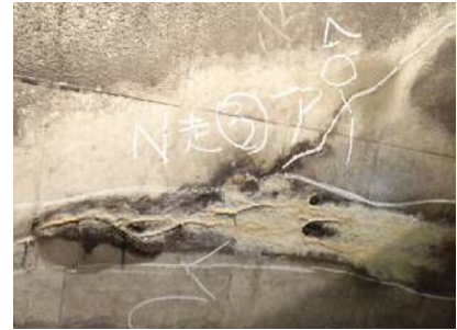
ひび割れ付近の漏水(遊離石灰)
