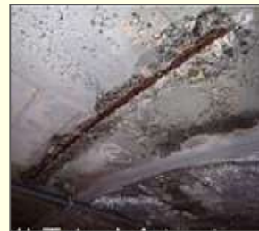
写真 鉄筋の露出状況
