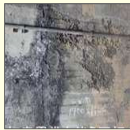
写真 コンクリートの劣化状況
