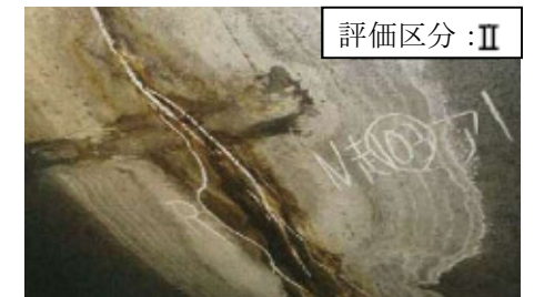
写真-漏水状況の評価事例
