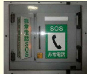
写真 非常電話設置状況
