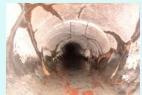
ひび割れが生じている下水道管
