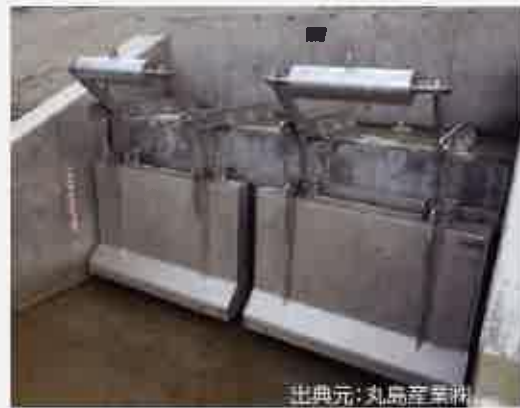
(写真2:フラップゲート)
