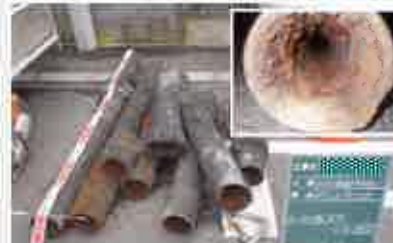
(写真4:老朽化した水道管)
