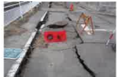
(写真3: 地震で被災した管による陥没)
