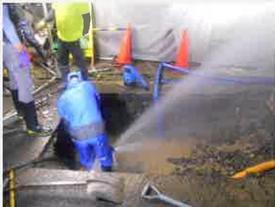
(写真3: 水道管漏水の様子)
