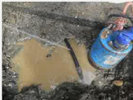
(写真4: 給水管漏水の様子)
