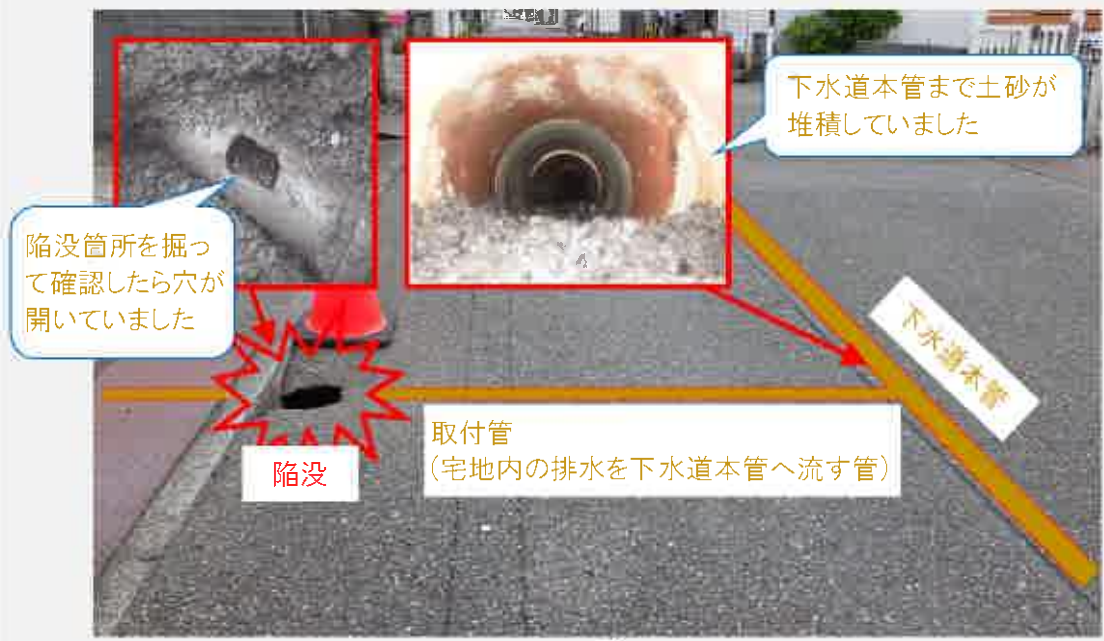
(写真5: 取付管破損による道路陥没)
