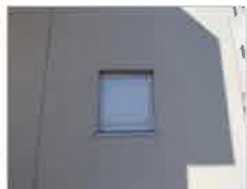
(写真5:窓の閉塞)
