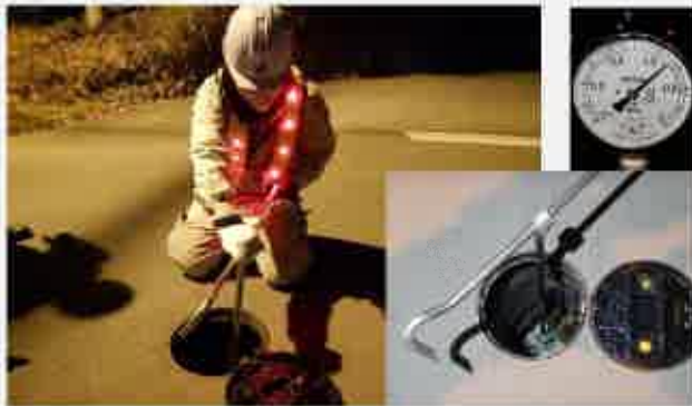
(写真:ブロック化に必要なバルブ操作等の状況)
