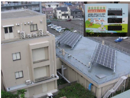
太陽光発電設置状況
