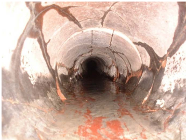
下水道管全体にクラック(ひび割れ)及び、破損が生じている様子
