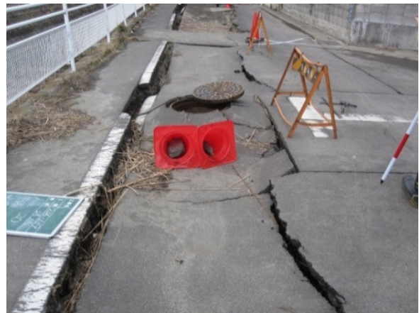
マンホール周辺の道路陥没状況
