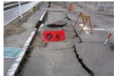
(写真3: 地震で被災した管による陥没)
