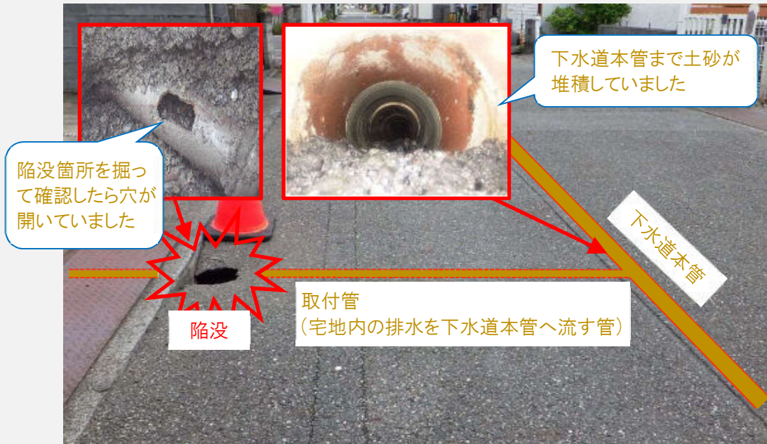
(写真5: 取付管破損による道路陥没)
