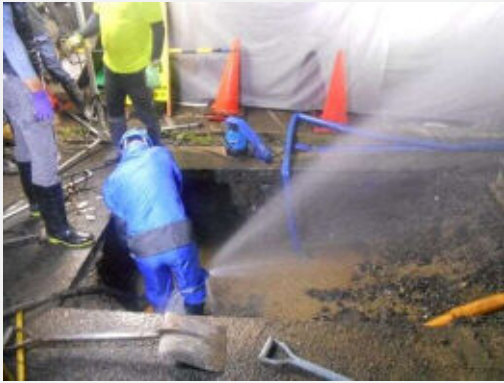
(写真3:水道管漏水の様子)
