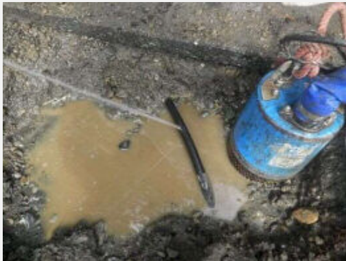
(写真4:給水管漏水の様子)
