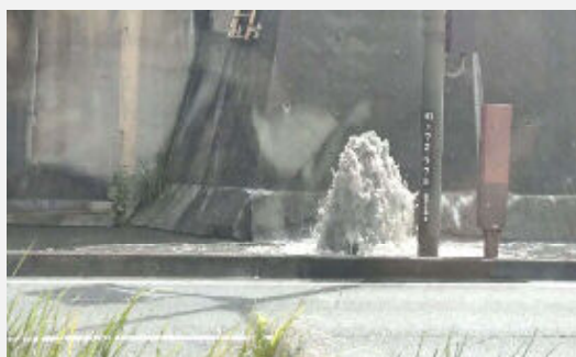
(写真1:漏水状況 清水区吉川地内(国道1号)(令和元年9月))
