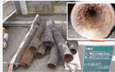
(写真4: 老朽化した水道管)
