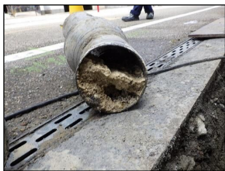
油がこびりついてしまった下水道管
