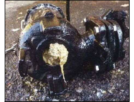
布が詰まり、汚水をくみ上げられない状態のポンプ
