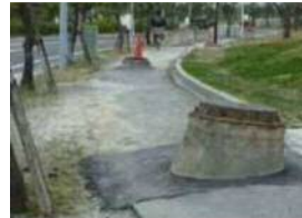
【マンホールの浮き上がり】
