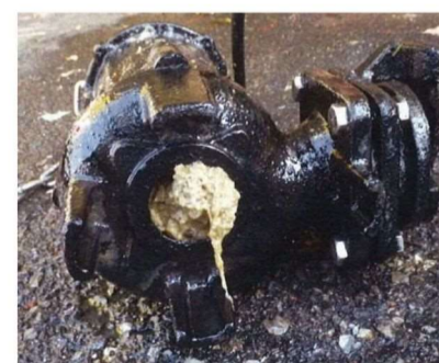
布が詰まり、汚水をくみ上げられない状態のポンプ
