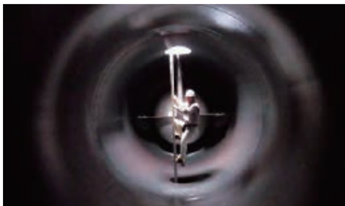
貯水槽内部の様子 人の大きさと比較してみてください。
