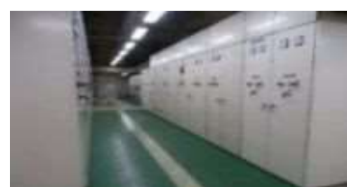
静岡庁舎受変電設備
