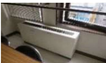
静岡庁舎空調設備(ファンコイルユニット)
